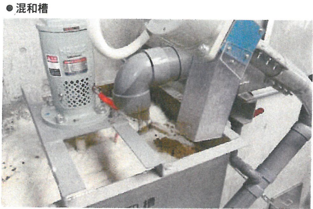
● 混和槽 「リセルバー」と汚泥・廃水を混ぜる水槽。脱水ケーキの質や量が変わります。
